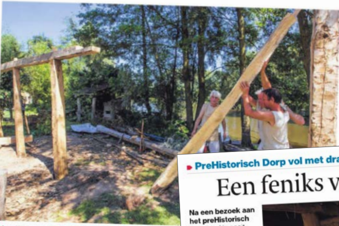
▲ Leo Wolterbeek (r) plaatst samen met twee vrijwillige eiken palen voor een nieuwe schuur in het Prehistorisch Dorp.
