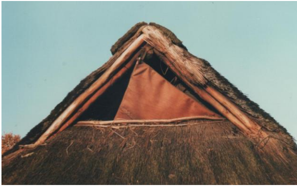
Hieronder 2 oplossingen, gezien in Naesbi in Denemarken. Allereerst een rook-luik, van planken, dat van binnen uit, met een touw dichtgetrokken kan worden. Ten tweede worden de wisjes met planken, die dakpansgewijs over elkaar vallen, bedekt, zodat de reparaties van het riet langer uitgesteld kunnen worden. Een mooie oplossing.
